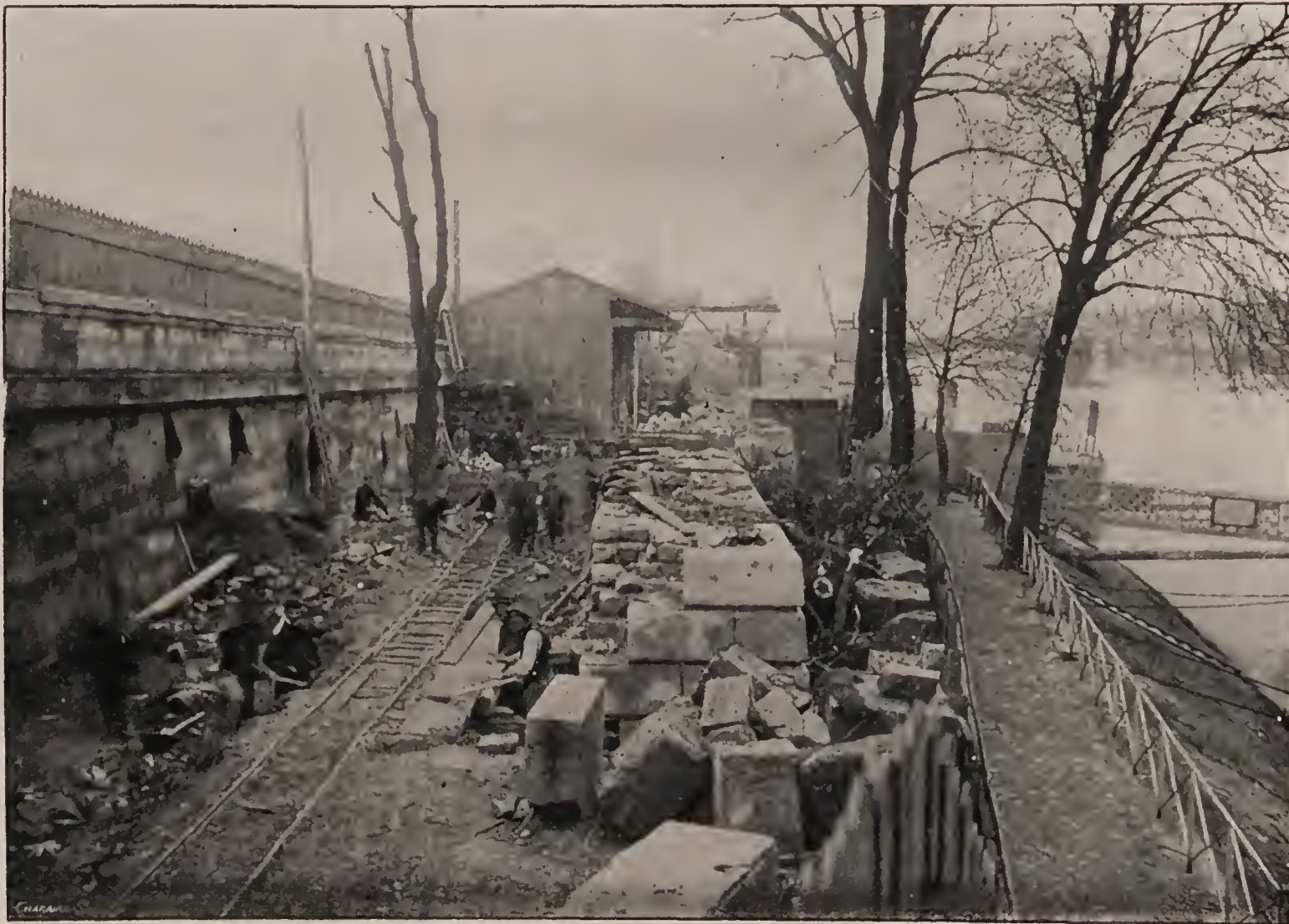
LE PROLONGEMENT DES LIGNES DE LA C ie D'ORLÉANS. — Chantier du pont Sully.
